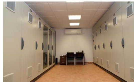
Figura 12. Sala de control y armarios eléctricos
