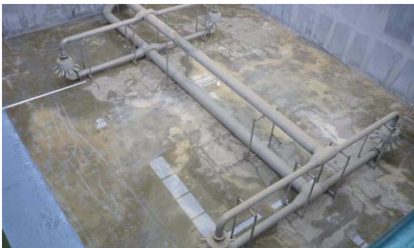
Figura 9. Sistema de eyectores en el reactor de nitrificación.
