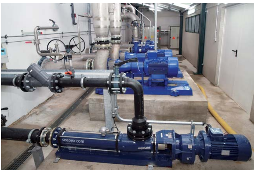
Figura 13. Aspecto de diferentes equipos de la depuradora de lixivios en Meruelo
