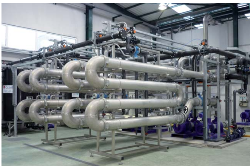
Figura 11. Unidad de ultrafiltración de membranas externas
