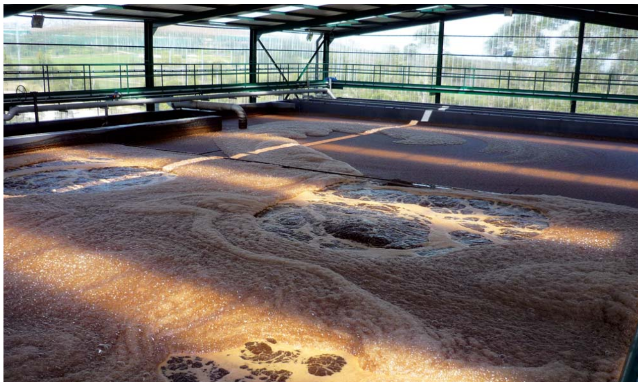
Figura 1. Reactores biológicos de la Planta de Lixiviados de Meruelo
