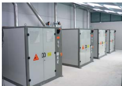
Figura 10. Sala de soplantes en la depuradora de lixiviados de Meruelo
