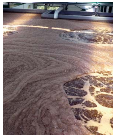
Figura 6. Reactor de nitrificación aeróbica
